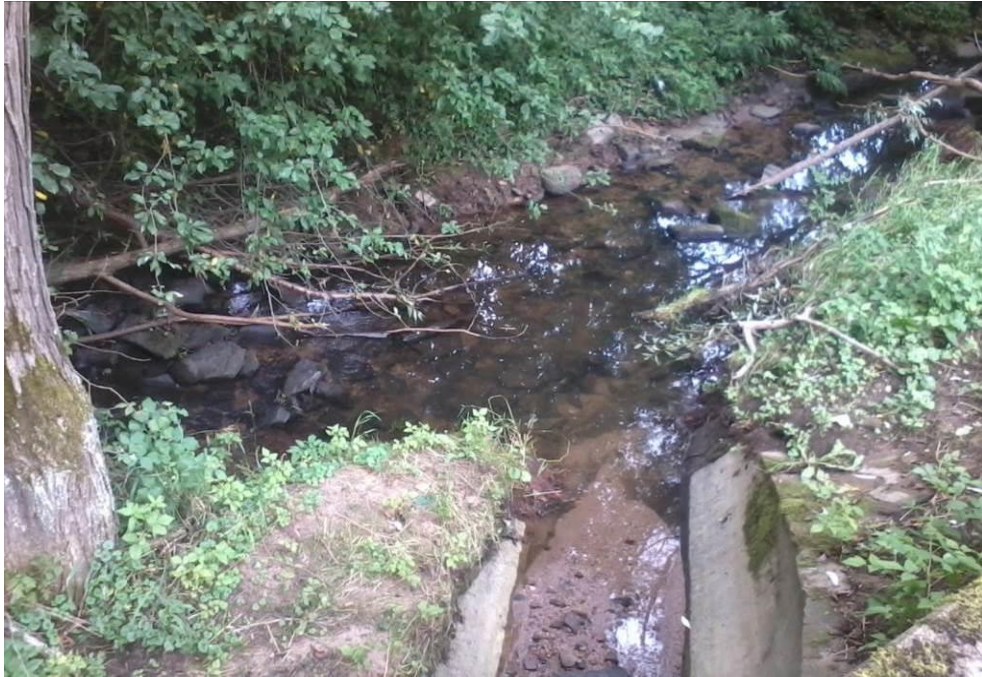
Bild 27 Einleitung in den Bocksbach nördlich von Karlsbad-Langensteinbach V. Gaschick 13.08.2013
